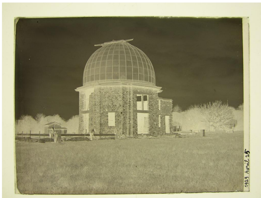
FIG.1 : CONSTRUCTION DE LA COUPOLE DE LA TABLE ÉQUATORIALE DU 28 NOVEMBRE 1928 AU 25 AVRIL 1929 (LOT 31)
